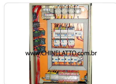
Panel eléctrico de comando de la bruñidora BH-200 con contactores, relés y sistema de cableado
