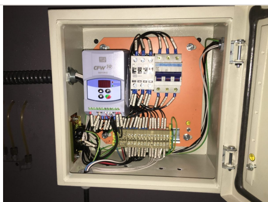
Detalle — Panel eléctrico con inversor CFW10 y contactores para control de rectificadora RVC-1000M
