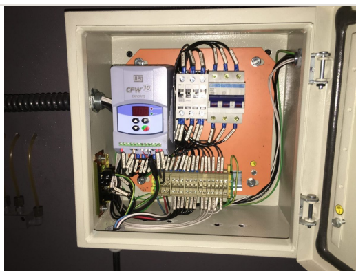
Detalhe — Painel elétrico com inversor CFW10 e contadores para controle da retífica RVC-1000M
